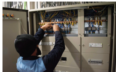
شماره‌گذاری سرخط تابلو برق طبقه ۶
