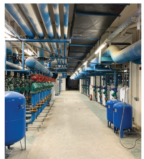
راه‌اندازی موتورخانه مرکزی و استفاده از سیستم گرمایشی در کل برج
